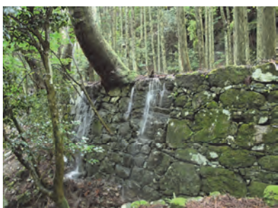
図表 137 石垣を毀損させる樹木 (慈欽坊跡)
